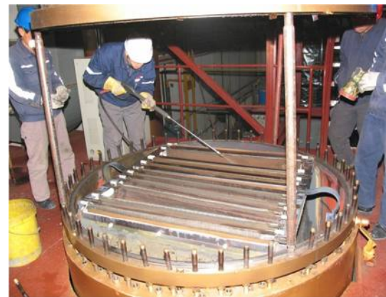
金泥容易清理，由压力水即可 Снятие катодного осадка производится легко - с помощью воды под напором
